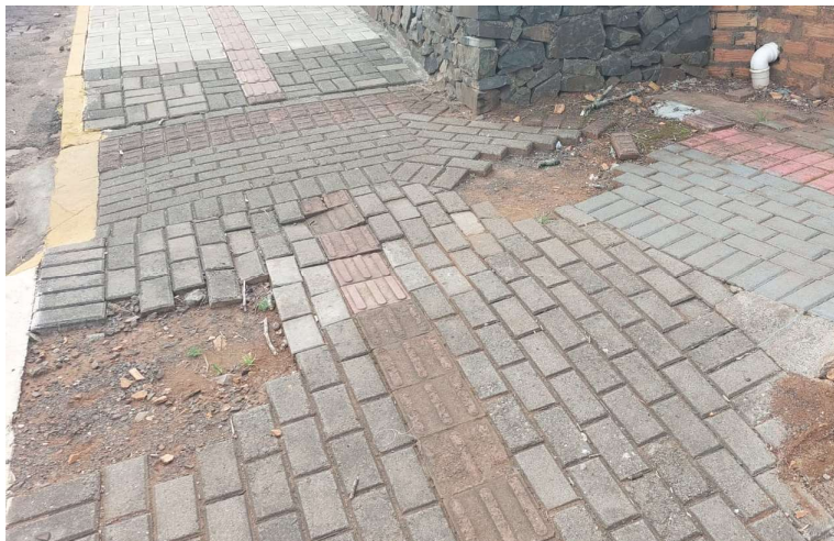
Foto 02: Adequar e executar passeio público.
